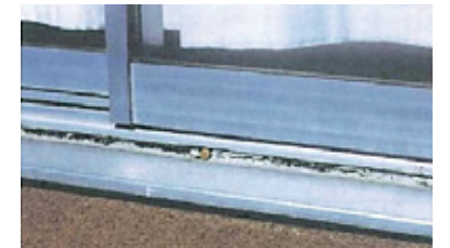
外壁・建具の周囲の劣化
