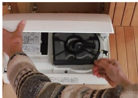
4 脚立でメンテナンスできる位置に設置された例
